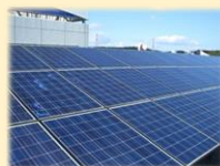
事務棟屋上 ソーラー発電 パネル
