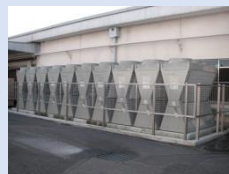
現在使用している ヒートポンプ式 空調機
